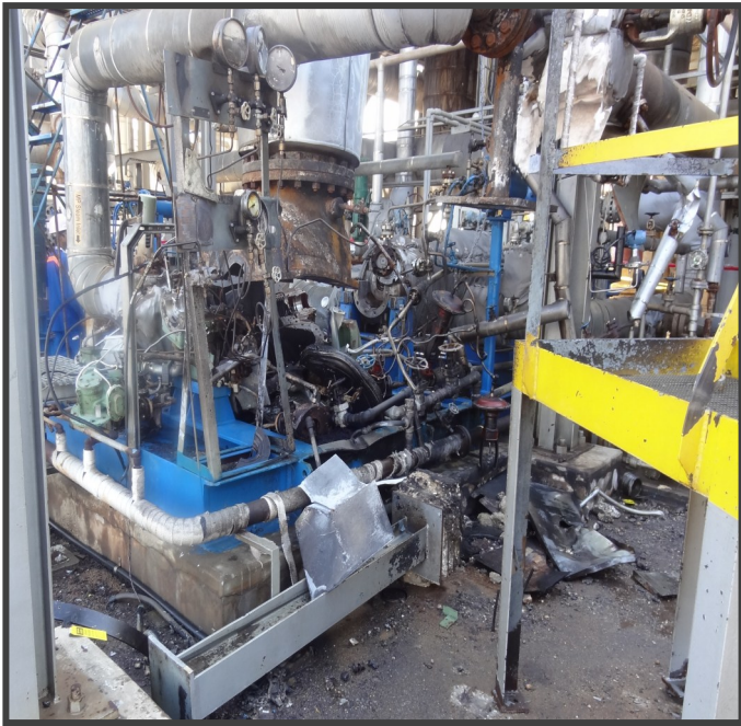
Turbine Failure, Trinidad
